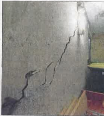
Marode: Die Nebengebäude am Stadion haben sichtbare Schäden.
